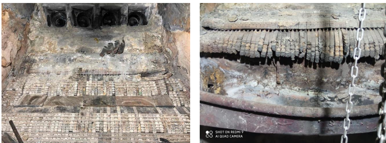
Рисунок 1.31 – Топка котла Hurst Boiler с НПП, прогар колосников и разрушение обмуровки.
