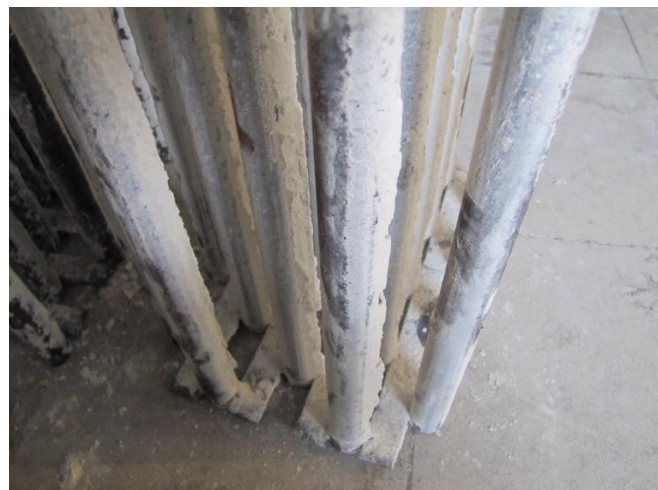
Рисунок 3.24 – Внешний вид отложений, закрепившихся на трубах
