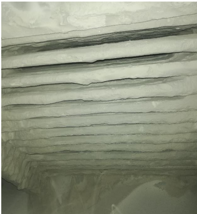
Рисунок 3.25 – Вид натрубных отложений в экономайзерах с шахматным расположением труб
